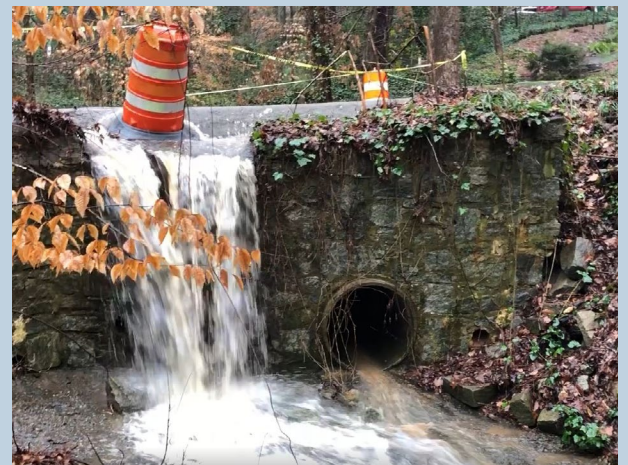
Abajo: El problema de las aguas pluviales antes.
