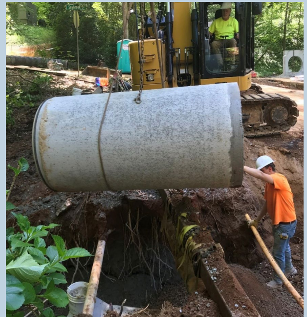
Arriba: Arreglos realizados en infraestructura de aguas pluviales en Inman Drive y Saybrook Drive en marzo de 2020, reemplazando tuberías de drenaje con una sola alcantarilla de 36”.
